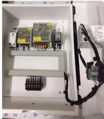
ภายในกล่องควบคุม
