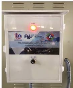
จุดติดตั้งกล่องควบคุม
